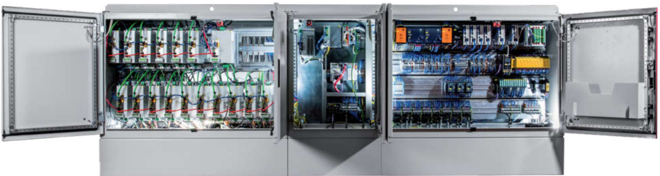
Blick in den neuen kompakten Schaltschrank
